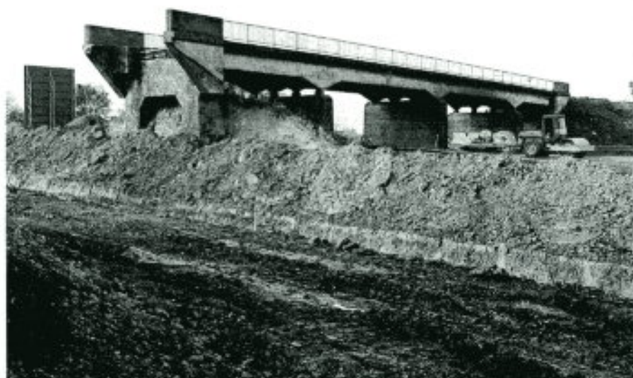
Vor dem Aufbau steht oft der Abbruch: Unmittelbar vor dem GVZ wird die A 14 auf sechs Spuren erweitert und die ICE-Trasse gebaut. Alte Brücken müssen weichen.
