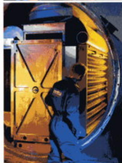
EINZELZELLEN von CD-Größe werden im Bild oben zu Stapeln (engl.: „stacks“) geschichtet. Darunter: Techniker bei der Montage eines „Hot Module“-Kraftwerks.
