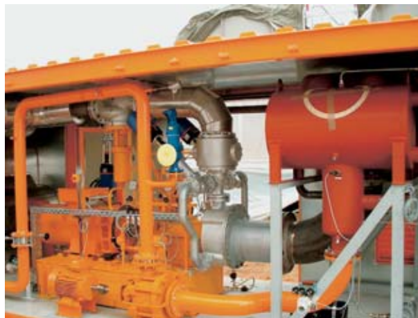
Container der ersten deutschen Organic Rankine Cycle-Turbine (OCR) im Erdwärmekraftwerk in Neustadt-Glewe (Fotos: Archiv Vattenfall)
